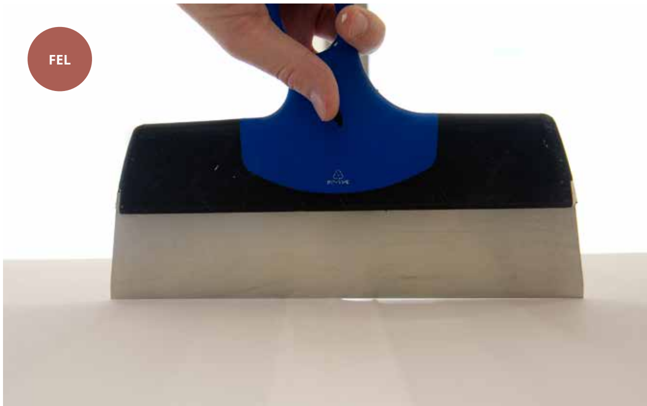
För tjockt lager spackel under spackelremsan. Spackelremsan ligger för långt ut från skivskarven. Påföljden blir en synlig förhöjning, en s.k.rygg över skivskarven även efter andra skarvspacklingen.
